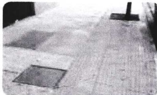
Incorreta. Apesar do acabamento do piso estar correto, as tampas não estão localizadas na faixa de serviço.
