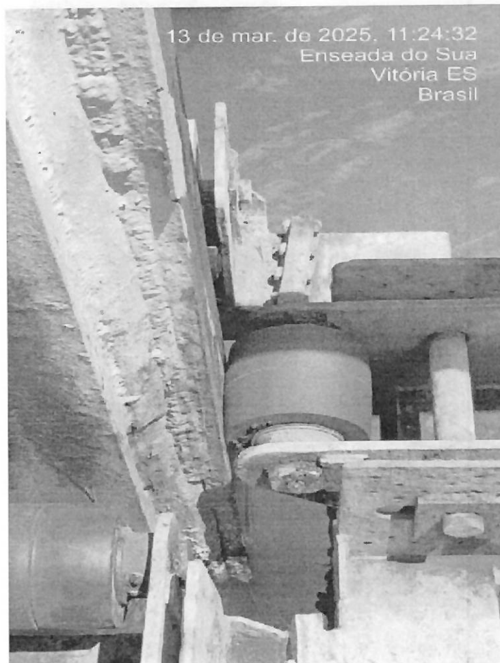
Figura 6 – Foram encontrados espaçadores de roletes travados o que facilita o rompimento do rolete.
