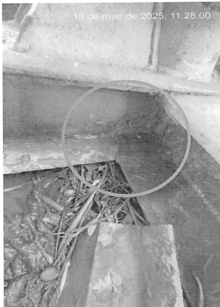
Figura 14 – Trinca na travessa junto ao chassi da passarela, ocasionando transferência de esforços para todo o conjunto da passarela e motivando as quebras e trincas das conexões.
