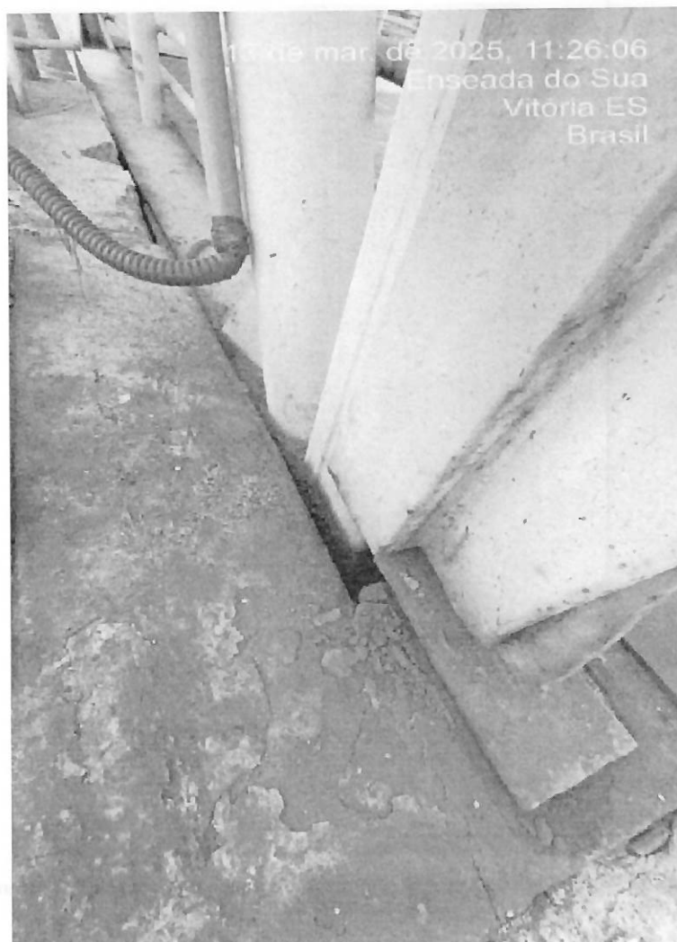
Figura 12 - Diferença de desnível prejudicando patola de apoio para içamento e manutenção. Ambos os lados
