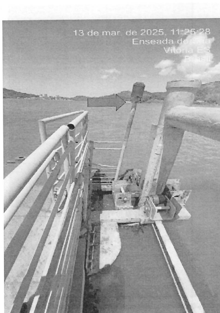
Figura 10 – Guarda corpo do flutuante com pontalete sinalizador avariado por colisão com embarcação.
