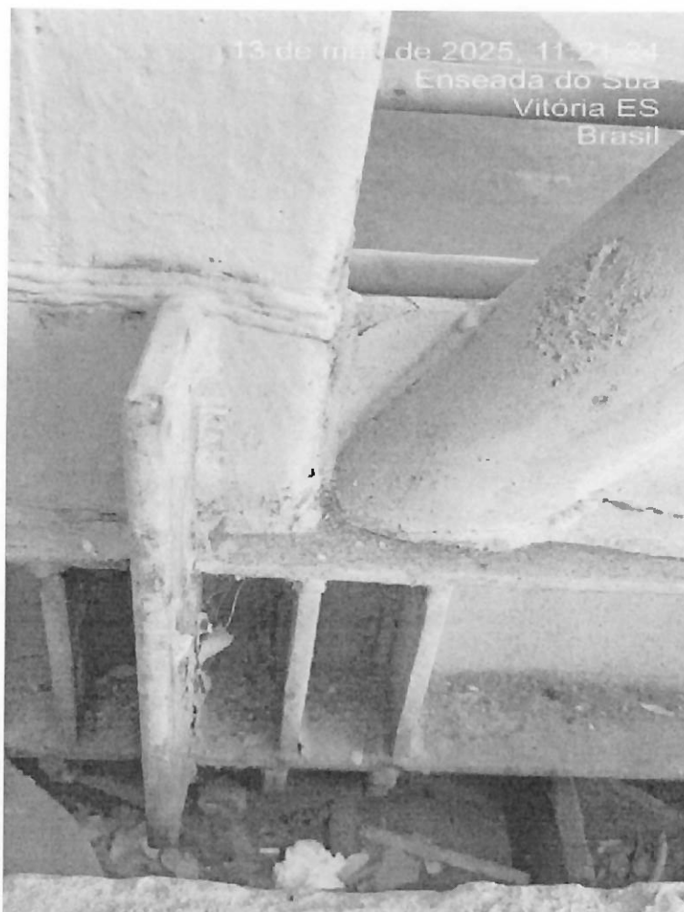
Figura 3 – Trinca na base inferior da passarela do lado direito indicando problema no funcionamento da esfera com presença de ruídos.
