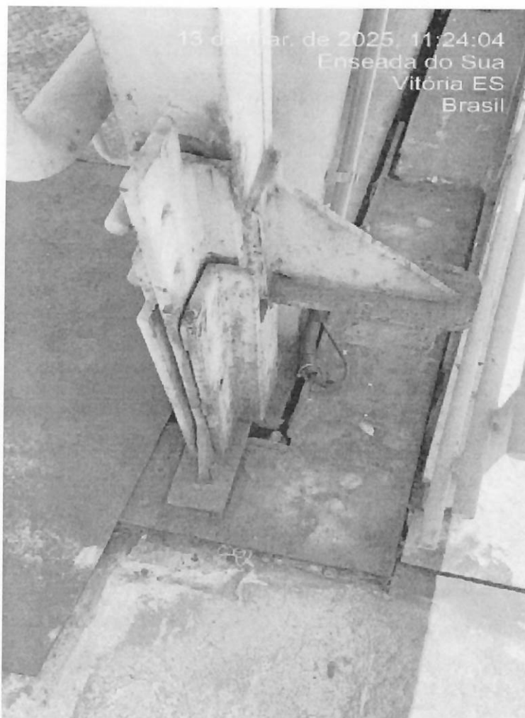
Figura 5 – chapa do contra testa que liga a passarela ao flutuante encontra-se com trincas nas soldas e rompimento nos pontos de chumbeação junto ao piso.
