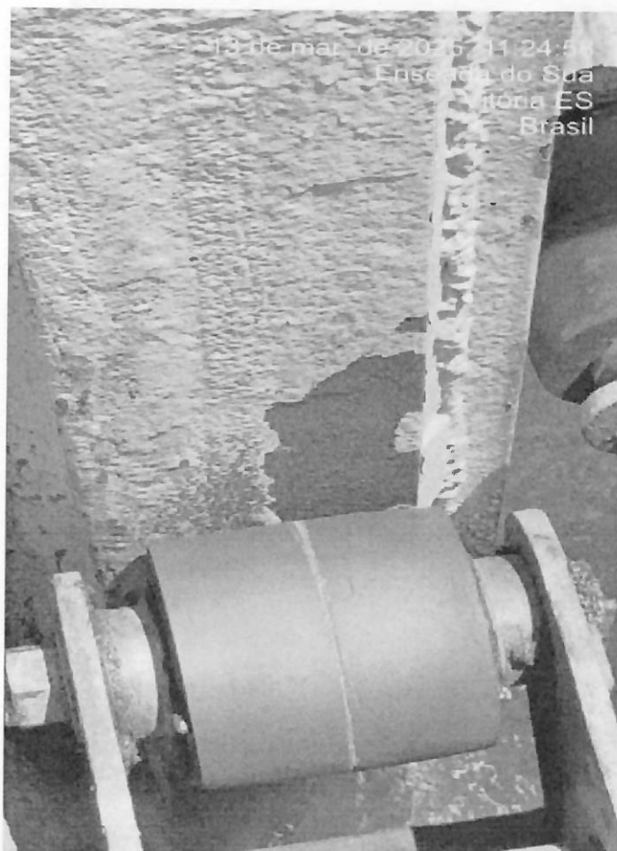
Figura 7 – Rolê apresenta lona e pequenas fissuras, tendo a necessidade do rodízio para mantê-lo em uso.
