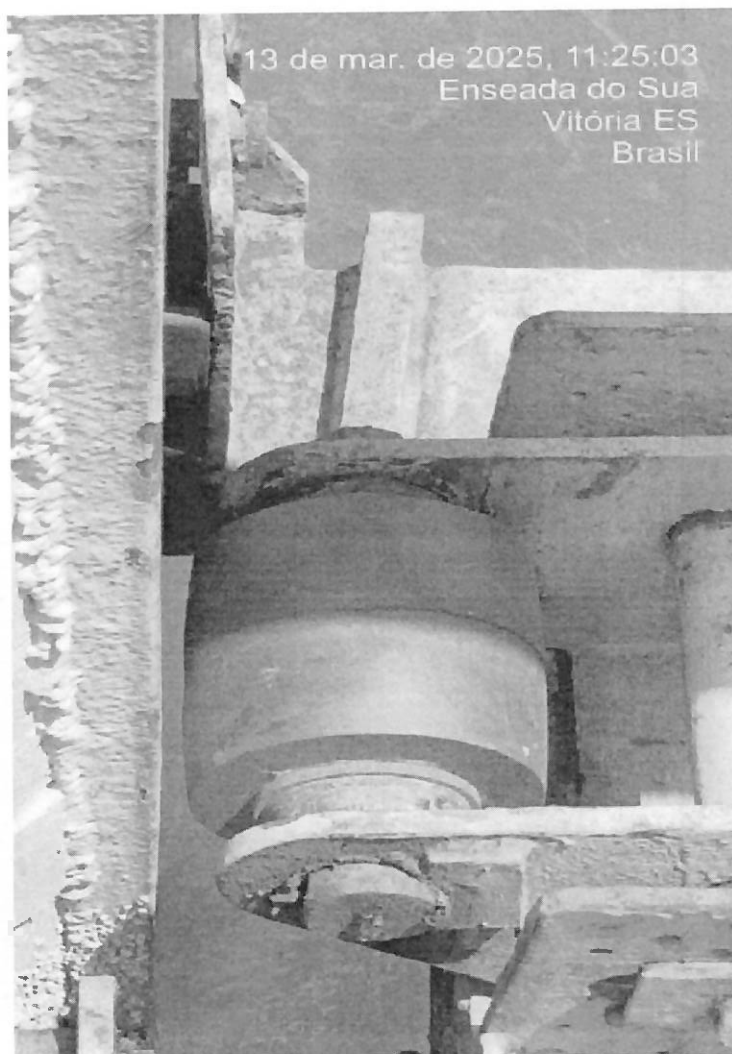
Figura 8 - Foram encontrados espaçadores e eixo de roletes travados o que ocasionou o giro do eixo junto a trava, correndo risco de rompimento dele.
