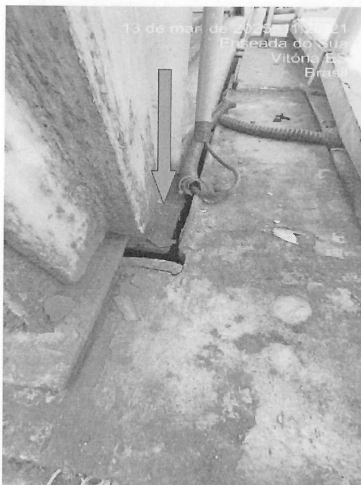
Figura 13 – Rompimento da chapa de sustentação do subleito da passarela.
