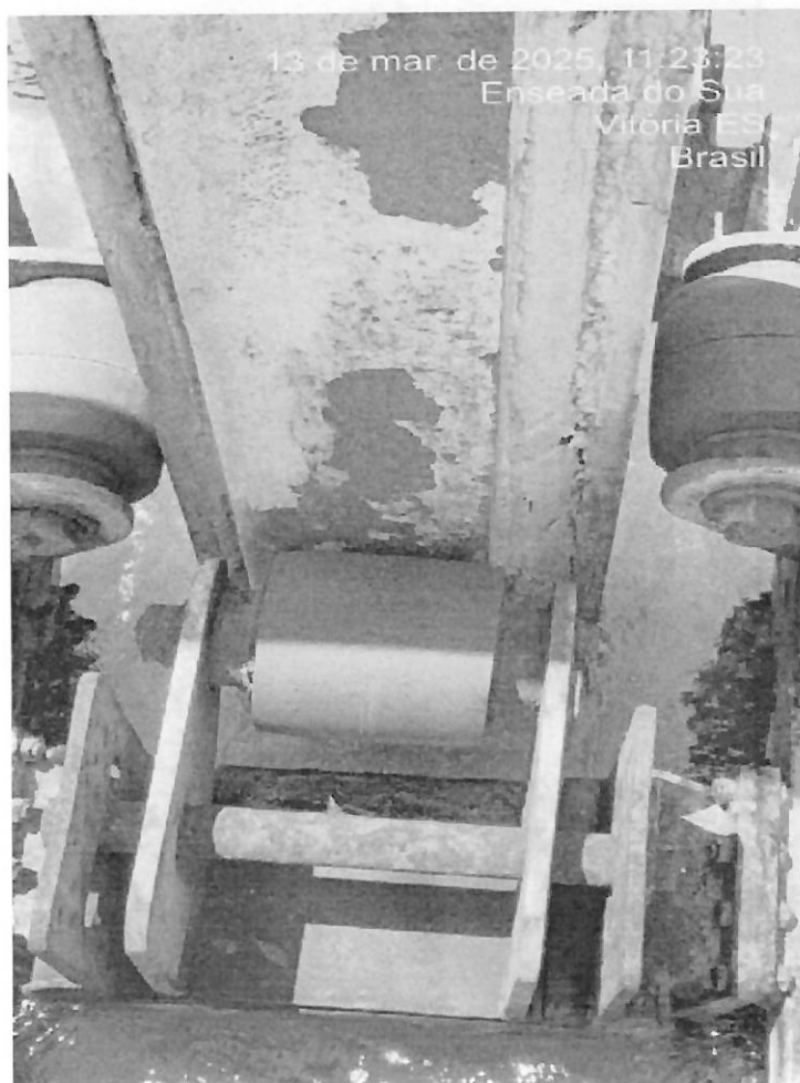
Figura 4 – Roletes apresentando desgastes. Com base na última troca, o mesmo possui vida útil de 30 dias caso seja mantido rodízio, o que não está sendo feito, sendo assim, pode romper com 1 semana. Tendo em vista que são peças que precisam de encomendas e levam o prazo de 45 dias de usinagem e vulcanização para entrega.
