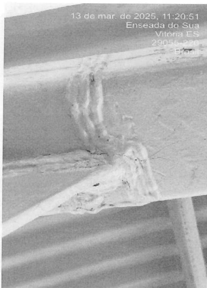
Figura 1 – Trinca no mesmo local da última ocorrência relacionada a transferência de torção do flutuante para a passarela – lado entrada da bilheteria sentido flutuante superior esquerdo.
